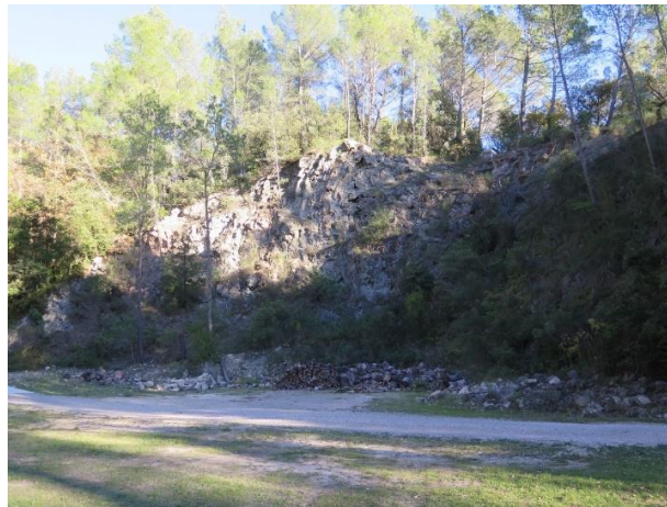
Effondrement du Baou, flanc Est, source BRGM (06/12/2021).
