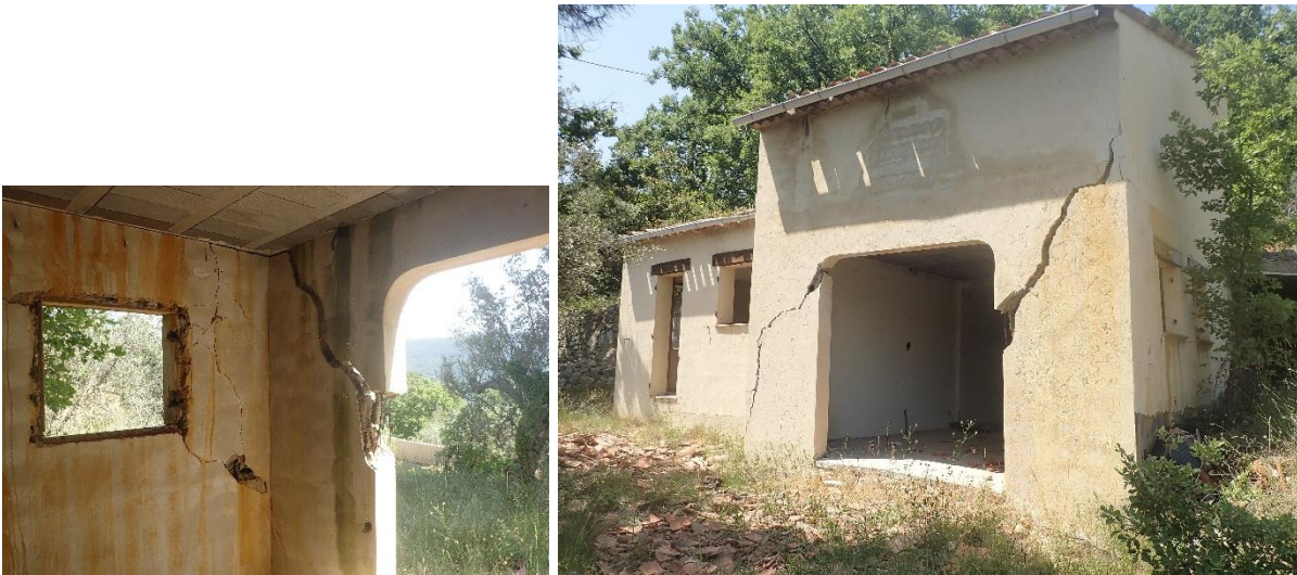
Fissuration affectant la maison coté sud-ouest, Peyrui.
